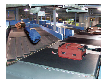
クロスベルトソーター(空港手荷物用)
